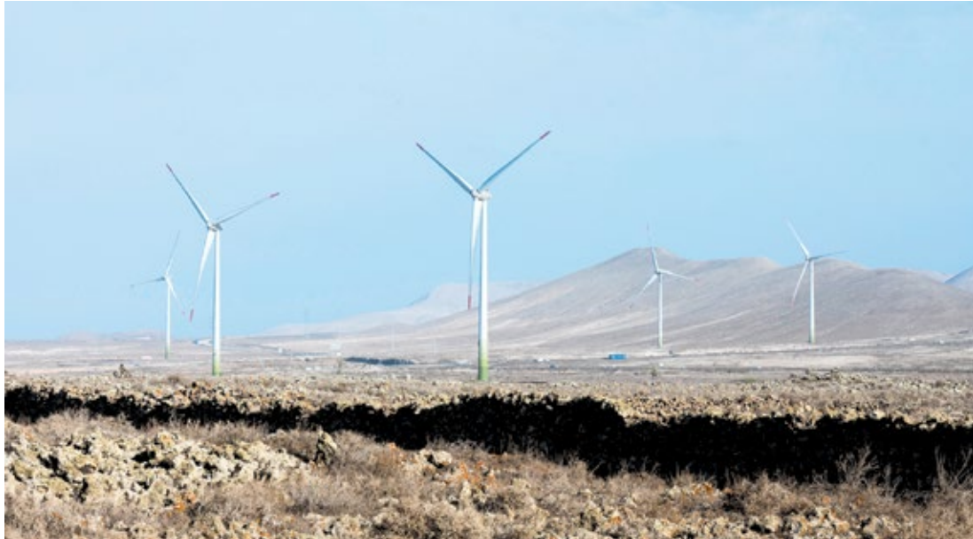
Aerogeneradores en el municipio de La Oliva.
