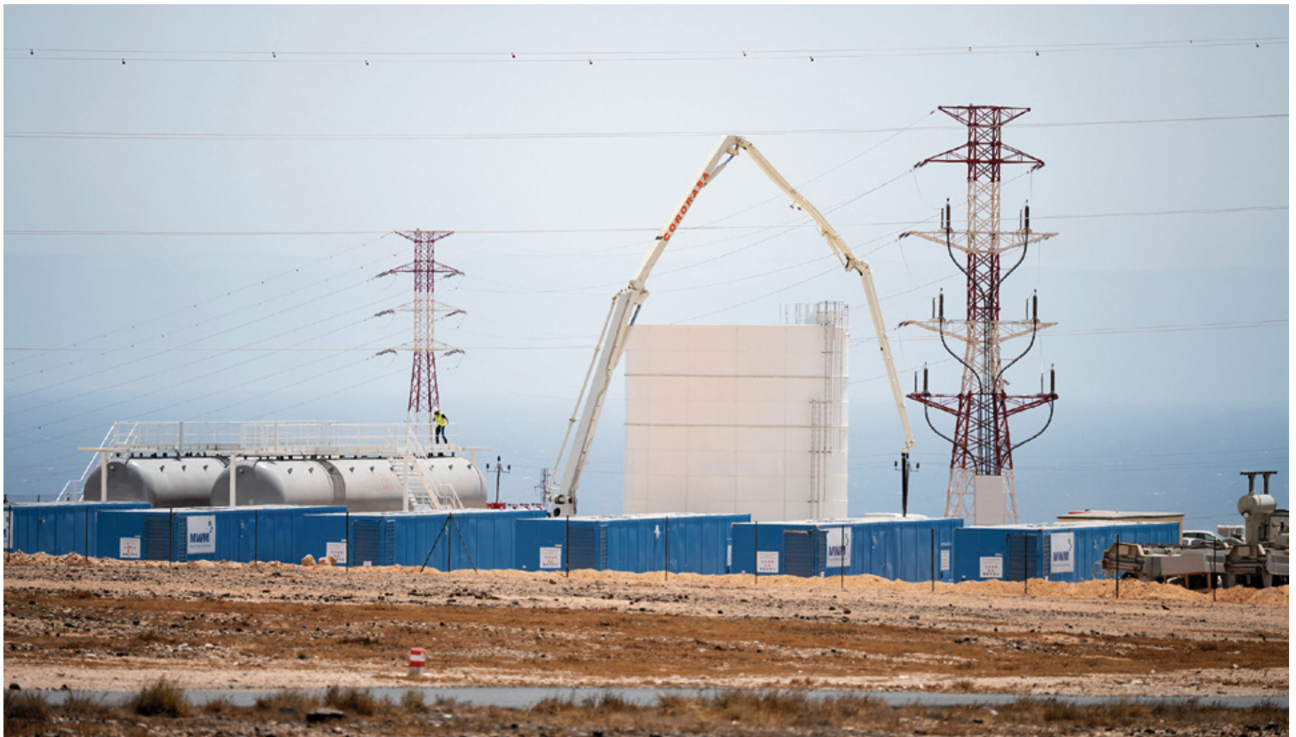
Nueva planta de energía de emergencia, en Puerto del Rosario. Fotos: Carlos de Saá.
