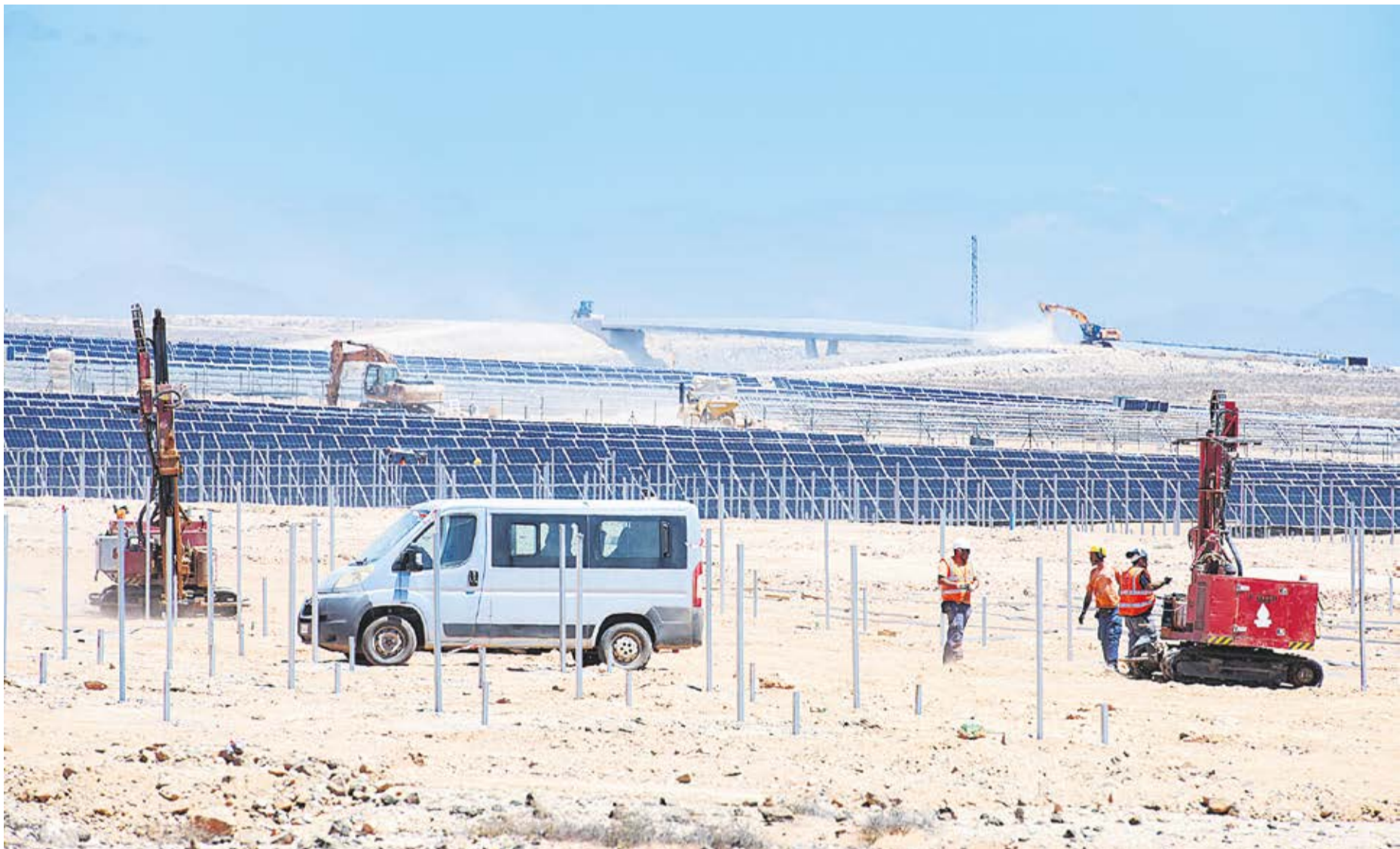
Operarios instalando placas fotovoltaicas en Puerto del Rosario. Foto: Carlos de Saá.
